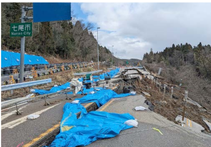
[写真3]能登半島地震で崩落した道路
